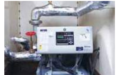
新設した加圧給湯ポンプ
