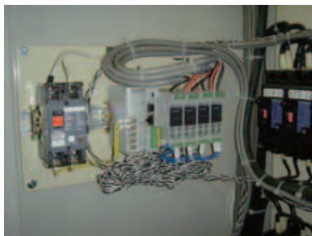
図1 計測器の外観・設置状況
