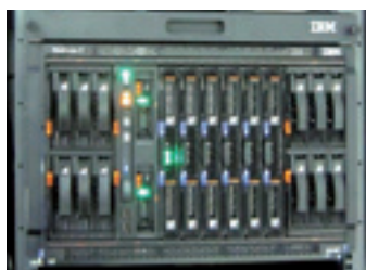
▲今回導入した大型サーバー
